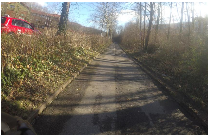
Abbildung 67: Beispiel für Sanierungsbedürftige Oberfläche am Walter-Gropius-Ring
